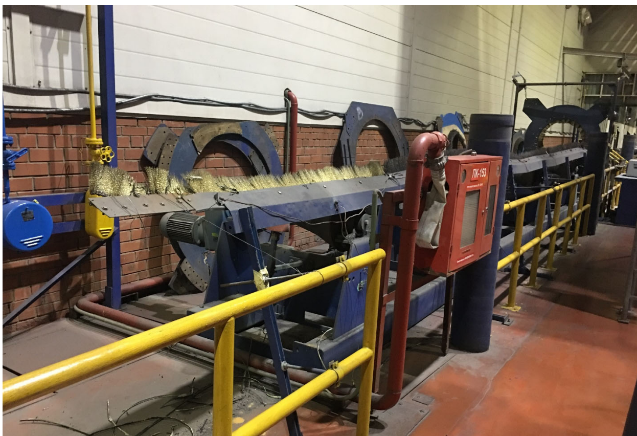
Рисунок 5.2.3 – Внешний вид линии контроля сплошности наружных покрытий труб
