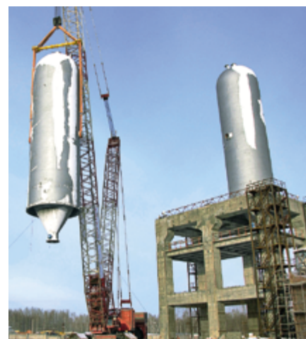
Рис. 1. Нефтехимический реактор (коксвая камера)
